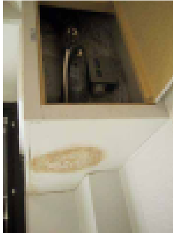
Vesi tiivistynyt rakenteissa
