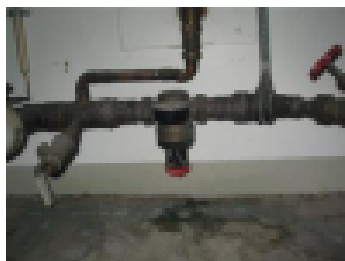
Vanhat korjatut vuotojäljet pitää poistaa
