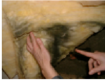
Ilmavuoto näkyy tummentumiona eristeissä ja purut lahoaa
