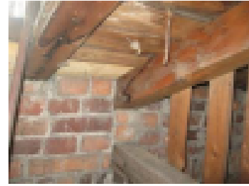
Tuulettumaton räystäs remopntin jäljiltä on suunnittelemattomuuden tulos
