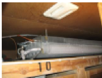
Jäähdytyspatteri levuuttaa kylmää ilmaa tiivistymään rakenteisiin
