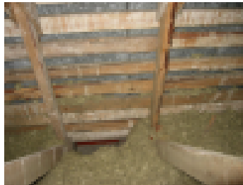
Tukittu räystästuuletus iheuttaa paannejäää ja vuotoja
