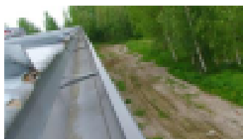
Taitteissa reikiä ja tiiviste puuttuu
