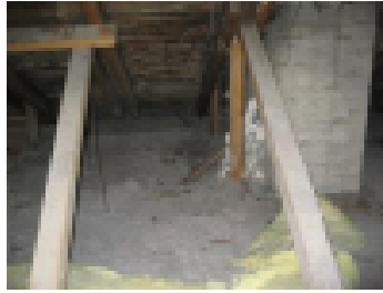
Yläpohjan korjaukset tehtävä kokonaisvaltaisesti
