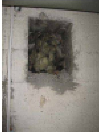
Kellarin raitisilmaventtiili on tukittu
